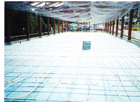
床面暖房配管
