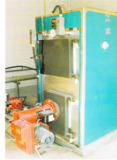
温水ボイラー
